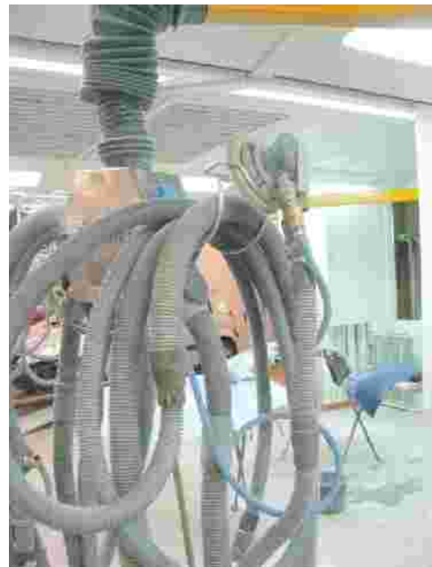
Mynd 6. Frásogskerfi í bílamálunaraðstöðu
